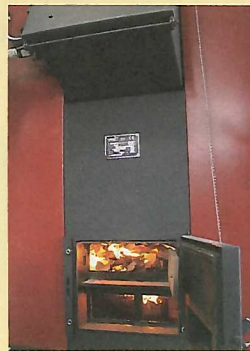
村内の温泉施設で使われている新ボイラー
